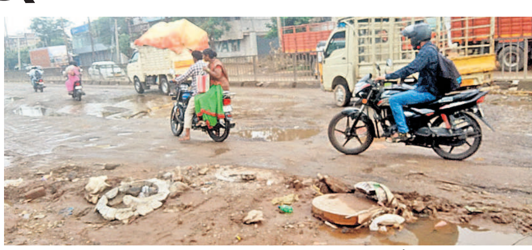
కాటేదాన్ నుంచి గగన్వహాడ్ వెళ్లే రహదారిపై ప్రమాదకరంగా మారిన రోడ్డు.
