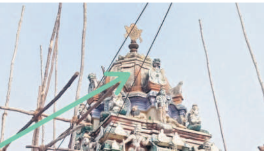
అలయ గోపురం మీద ఏర్పడిన పగుళ్లు
