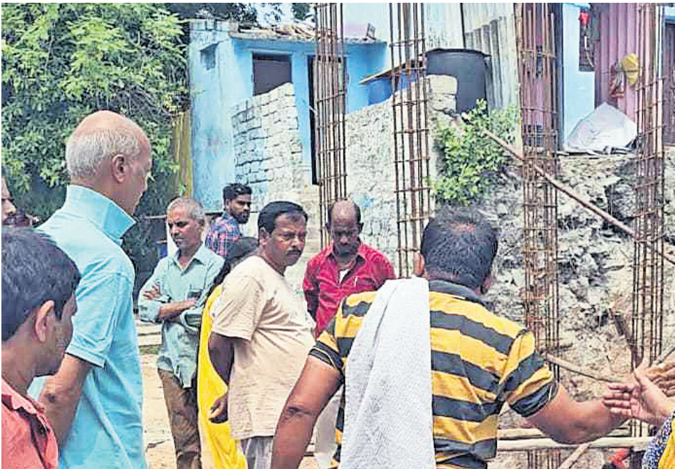
బాచపల్లి రాజ్‌గాంధీ నగర్‌లో రోడ్డును ఆక్రమించి చేపట్టిన నిర్మాణం
