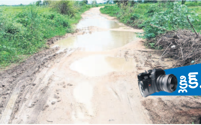
చిన్నపాటి వర్షానికి నీటి గుంతలతో నిండిన ఖత్వాం రోడ్డు
