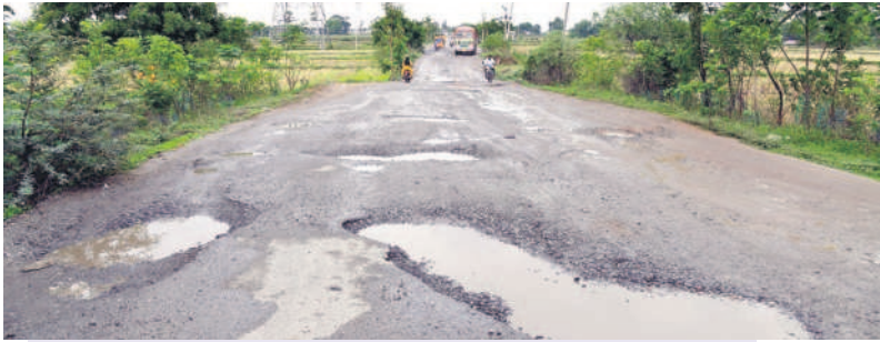
అన్నారం కల్వకుంట్ల వద్ద ధ్వంసమైన రోడ్డు
