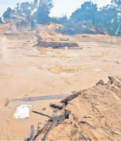
ములుగు జిల్లా ఏటూరునాగారం మండలంలోని జంపన్నవార్గుపై తెగిన తాత్కాలిక రోడ్డు
