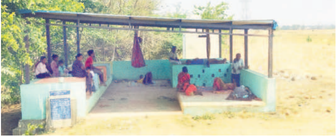
నేరేడుపర్తి మండలం దిల్లింపల్లలో నిరుపయోగంగా ఉన్న సిగ్రిగేషన్ షెడ్
