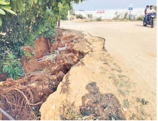
రాకొండ గట్టు కోతకు గురైన రోడ్డు
