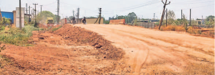
జమీరాబాద్ అల్లోల్ బైపాస్ రోడ్డు సమీపంలో అసంపూర్ణగా మిగిలిన బ్రిడ్జి, బీటీ రోడ్డు పనులు
