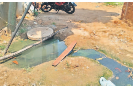
మాట్రాజ్ పల్లి మార్గంలో చాంబర్ ఫైకి వస్తున్న మురుగునీరు
