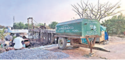
జాన్‌పహాడ్ గ్రామంలో ప్రైవేట్ వ్యక్తుల భవన నిర్మాణాలకు ఉపయోగిస్తున్న గ్రామ పంచాయతీ వాటర్ ట్యాంక్
