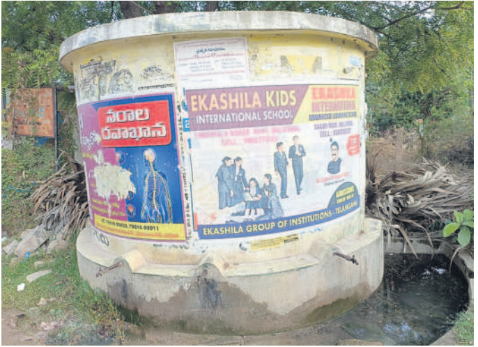
కట్టంగూర్ కత్తెర రోడ్డులో గల మంచినీటి ట్యాంకు చుట్టూ చేదన మురుగు
