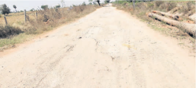
గుంతలమయంగా నేరేడుచర్ల - చూపాడు రోడ్డు
