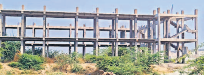
ఇంటిగ్రేటెడ్ మార్కెట్ నిర్మాణ పనులు నిలిచిపోవడంతో పెరిగిన సర్కారు కంపెనెట్టు
