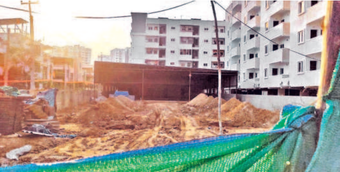
నిర్మాణ సమీపంలో ఎలాంటి అనుమతులు లేకుండా నిర్మిస్తున్న స్వీమ్మింగ్ పూల్
