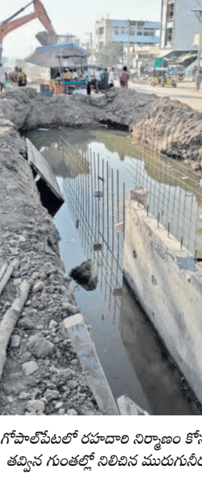
గోపాలపేటలో రహదారి నిర్మాణం కోసం తవ్వివ గుంతల్లో నిలిచిన మురుగునీరు
