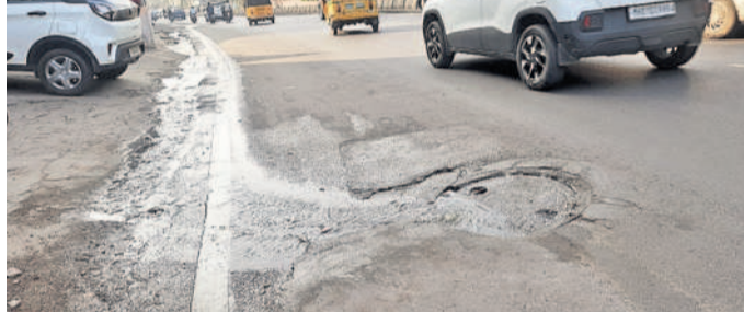
బజారుపార్ట్ లో నంబర్ 1లో ప్రధాన రహదారిపై మ్యాన్ హోల్ శిథిలావస్థలో ఉన్నది. వెస్ట్ ఆఫీసు చౌరస్తాపై వల్లే రహదారిలో రోడ్డు పూర్తిగా ముగిసినట్లు సర్వేలోని నీరు ఉలికి పన్ను చక్కనీ ఉన్న ప్రేమ్ సుగర్ గా
