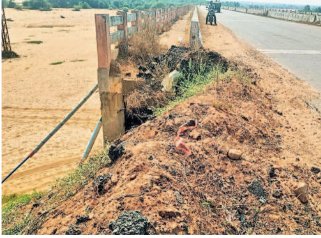
జంపన్నవారి బ్రీడ్జి పుట్టిపాత వద్ద దెబ్బతిన్న రోడ్డు
