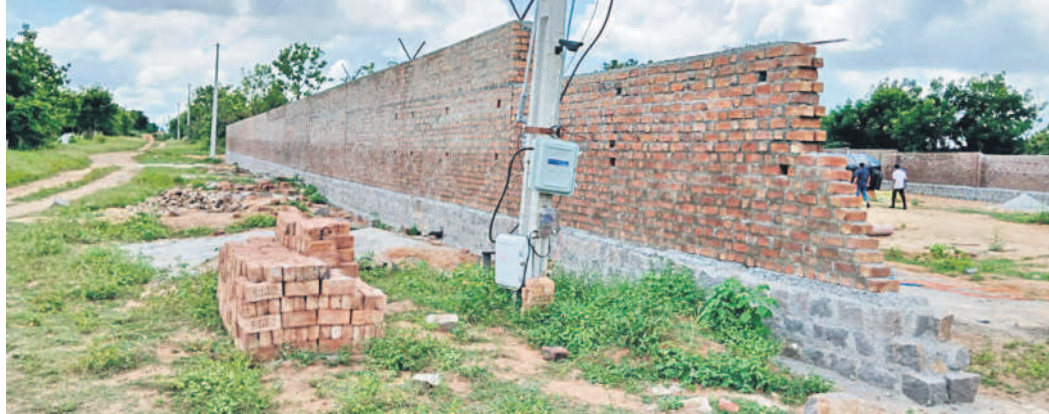
ఇబ్రహీంపట్నం పెద్దచెరువు పరిసర అక్రమంగా చేపడుతున్న ప్రాంత నిర్మాణం
