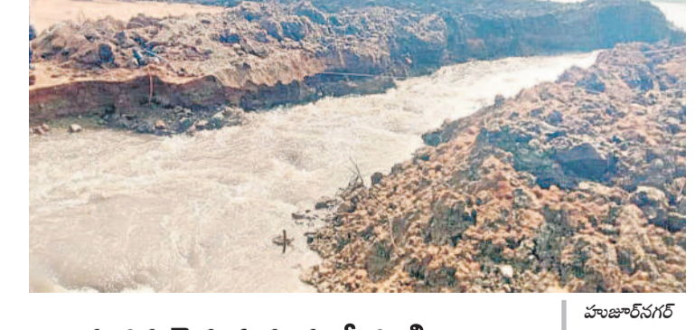
చూజూన్ గర్ రూరల్, సెప్టెంబర్ 22 : సూర్యాపేట చూజూన్ గర్ మండలంలోని బూరుగడ్ గ్రామం నల్లచెరువుకు శనివారం రాత్రి కురిసిన భారీ వర్షానికి మళ్ళీ గండి గండి వర్షం కురిసిన వారాంతో వరద ప్రమాదానికి నల్లచెరువుకు గండి పడటంతో గోపాపురం- బూరుగడ్ గ్రామం మధ్యలలో ఉన్న కొట్లకుపోయాయి. దాంతో పదిరోజుల పాటు రాకపోకలు నిలిచిపోయాయి. సమీప గ్రామాల ప్రజలు ఇబ్బంది పడ్డారు. మంత్రి కృష్ణ అవేళిగా ఆ తర్వాత అధికారులు తాత్కాలికంగా రోడ్లను ఏర్పాటు చేసి రాకపోకలను పునరుద్ధరించారు. కాగా శనివారం కురిసిన వర్షం
