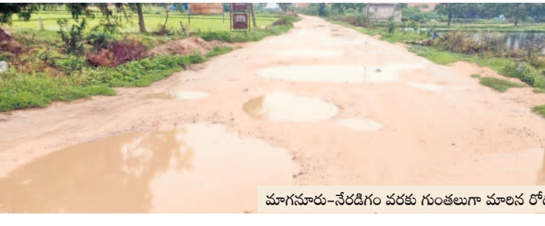
మాగసూరు - నేరడిగం వరకు గుంతలుగా మారిన రోడ్డు
