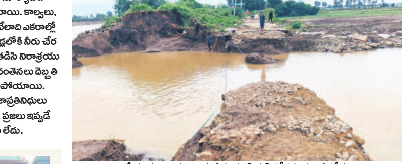
మేళ్లచెర్వు నాగుల చెరువుకు గండి పడి కోతకు గురైన రోడ్డు
