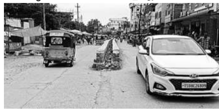
అసంపూర్ణంగా పడలిన డివైడర్ నిర్మాణం
