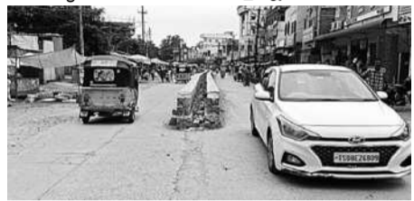
అసంపూర్ణంగా వదలిన డివైడర్ నిర్మాణం
