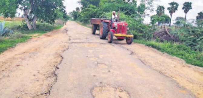
గుంతలమయంగా మారిన తిరుమలగిరి- తాటిపాముల రోడ్డు
