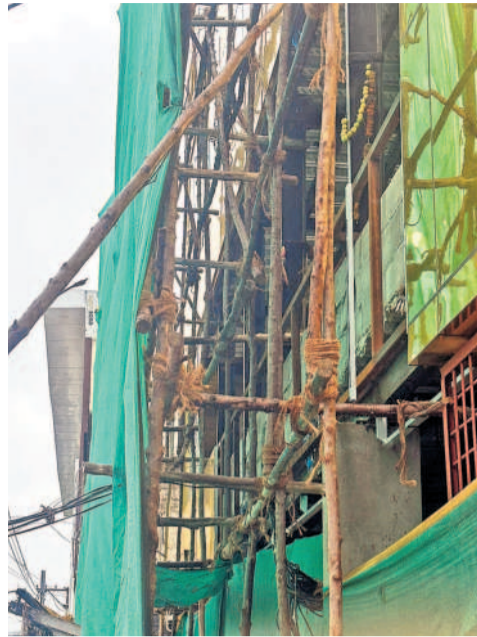
హబ్బిగూడ-రామంతాపూర్ ప్రధాన రహదారిలో ఇటీవల అధికారులు అక్రమ నిర్మాణాన్ని కూల్చివేసినా మళ్ళీ నిర్మాణం దృశ్యం
