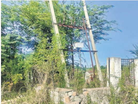
చిలిపిచెట్ల మండలం చందూర్ ఎత్తిపోతల ప్రాజెక్టు వద్ద ధ్వంసమైన ట్రాన్స్మిషన్ టవర్
