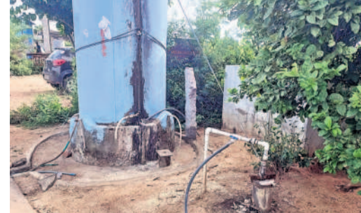
కుమ్మరివాడలో మరమ్మతులకు నోచుకోని సింగిల్ ఫేజ్ బోరు మోటార్ పంచాయతీ ట్యాంకర్లను కాంట్రాక్టర్లకు పంపారు
