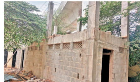
అసంపూర్ణంగా నిలిచిపోయిన నిర్మాణ పనులు
