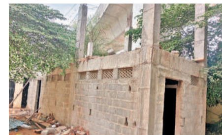
అసంపూర్ణంగా నిలిచిపోయిన నిర్మాణ పనులు
