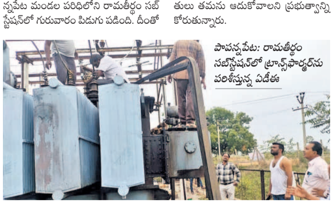
సావన్నపేట: రామతీర్థం సబ్స్టేషన్లో ట్రాన్స్మిషన్లను పరిశీలుస్తూ ఏడీఈ
