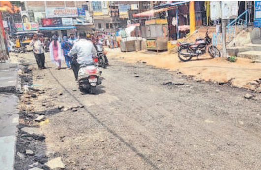
పార్లగుట్ట మార్గంలో మధ్యలో తప్పి పదిలైన రోడ్డు
