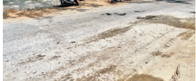
హత్తూర్ వలీబ కాలనీ వద్ద నాణ్యతాలోపంగా పనులు చేపట్టడంతో ధ్వంసమైన రోడ్డు
