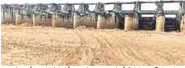
పనులు చేపట్టకపోవడంతో నిర్మాణవ్యూహం ఉన్న మేడిగడ్డ బరాజ్ ప్రాంతం
